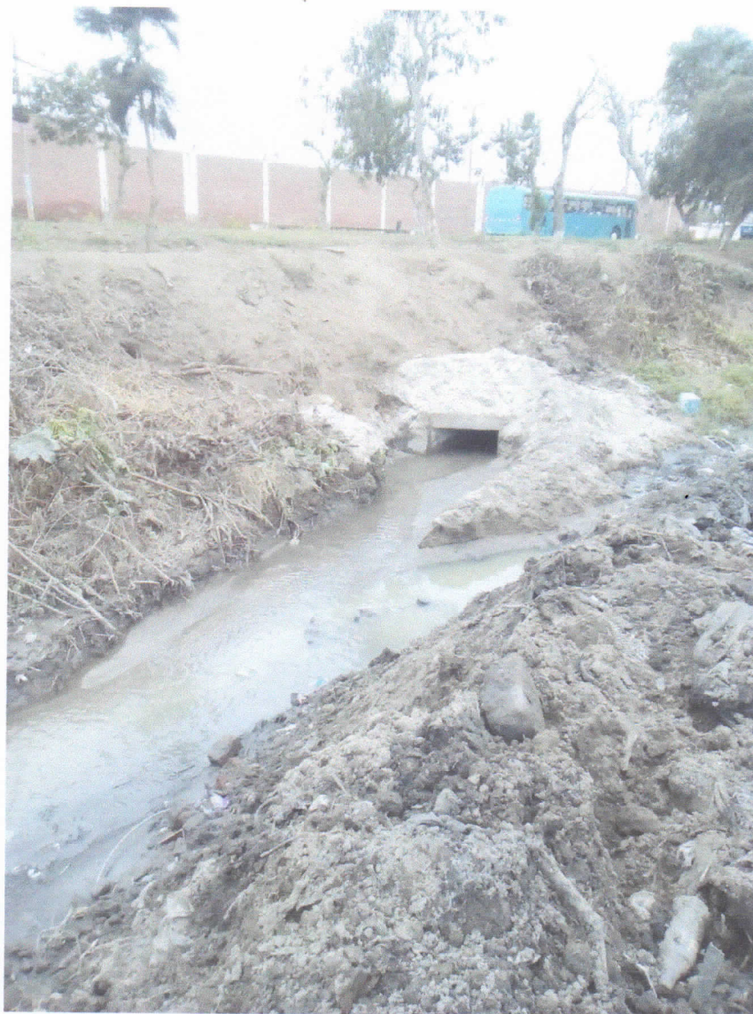
FOTOGRAFÍA N° 4.02: DESCARGA DE AGUAS INDUSTRIALES A CANAL MATRIZ
